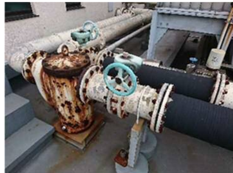
【ストレーナー老朽劣化状況（経年 35 年）】
