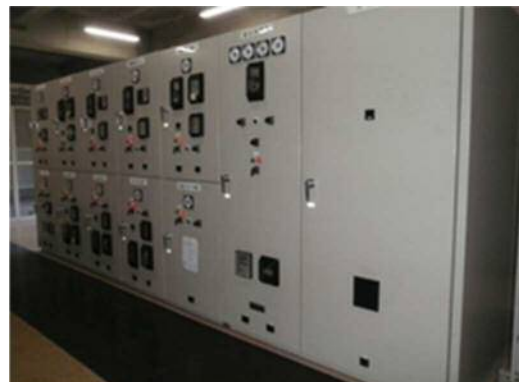
【高圧受変電設備老朽化状況 (経年 25 年)】
