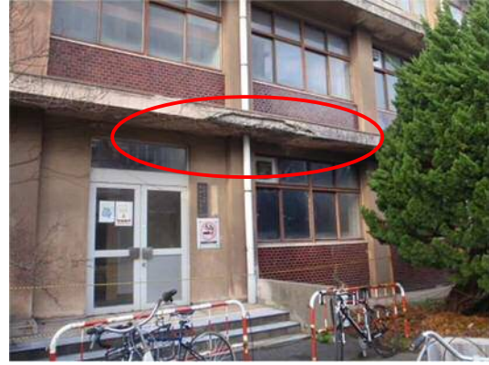
老朽施設の庇（経年 46 年）
