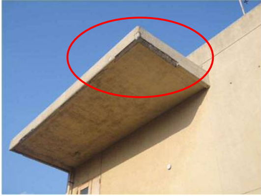
老朽施設の庇（経年 46 年）
