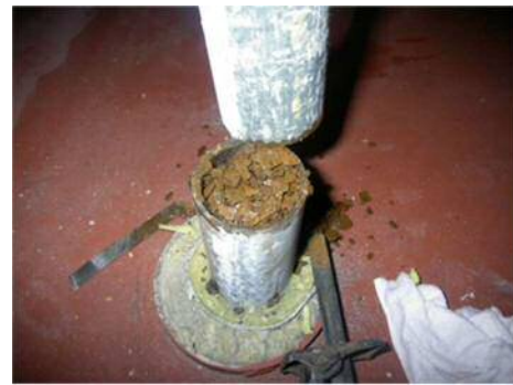
【空調ドレン管夾雑物状況（経年 26 年）】
