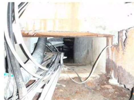
【電気配管配線劣化状況（経年 34 年）】
